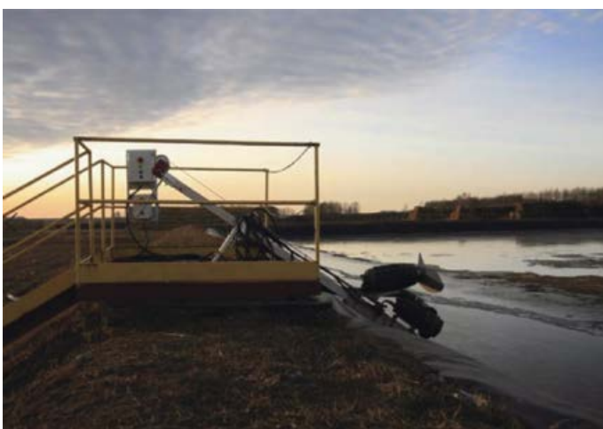
Фото 1. Стационарный погружной миксер с площадкой и системой опускания
